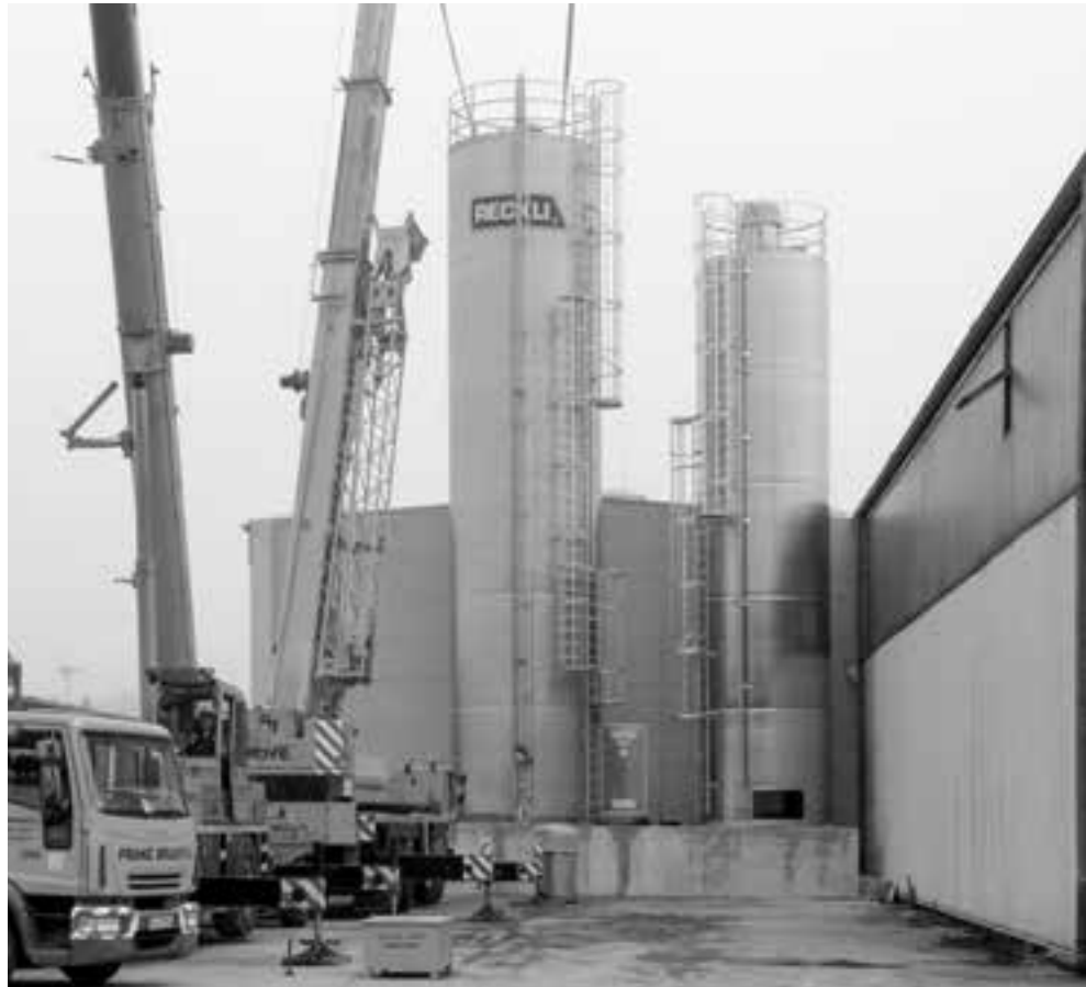
INSTALLATION DER RECKLI-SILOS
